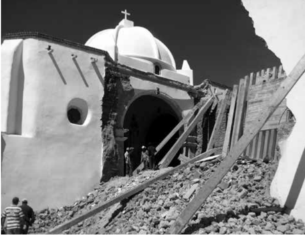
Figura 2. El muro sur del templo de Satevó, Chihuahua, México, construido con adobe, se derrumbó intempestivamente a consecuencia del uso de revoques de cemento. Fuente: Guerrero (2016).
