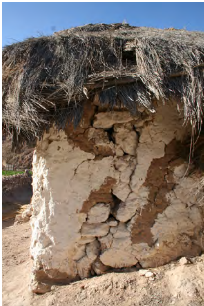
Grieta pasante vertical en el encuentro del muro testero con el muro del evangelio. San Isidro Labrador de Cobija.
