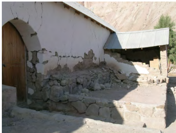
Colapso del muro poniente de la contrasacristía. San Pedro de Esquiña
