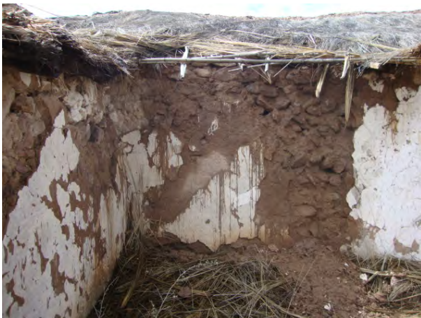
Erosión del muro de la epístola. San Isidro Labrador de Cobija.
