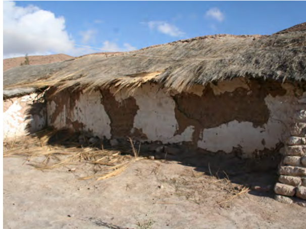
Desprendimientos de revoques. San Isidro Labrador de Cobija.
