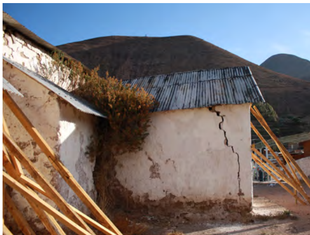
Presencia de arbustos en los muros de la iglesia de San Francisco de Asís de Socoroma.
