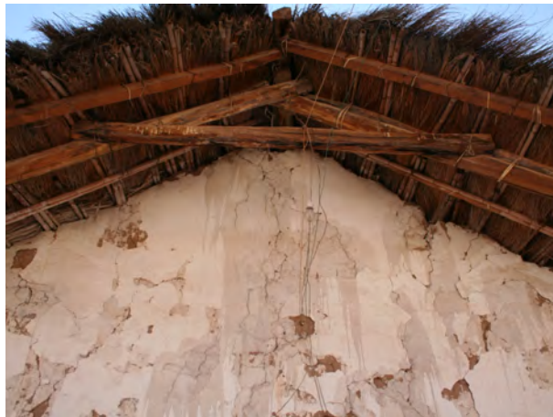
Fisuras en la portada del templo. San Isidro Labrador de Cobija.
