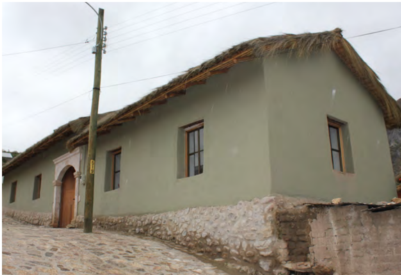
Vivienda restaurada en el poblado de Belén. Zócalos de piedra, muros de adobe, revoques de barro, enlucidos de tierra y cubierta de paja brava.
