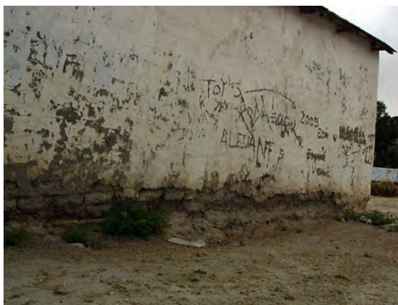
Erosión por humedad en la base de los muros de la iglesia de la Virgen de la Candelaria de Belén.
