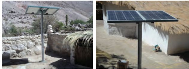
Sistema fotovoltaico para la iglesia de San Pedro de Guañacagua
