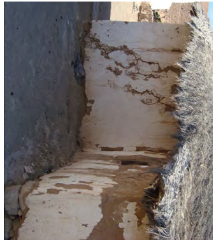
Grieta no pasante diagonal en el muro de la epístola. San Isidro Labrador de Cobija.
