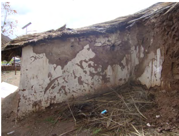
Sedimentación de material en la base de los muros. San Isidro Labrador de Cobija.
