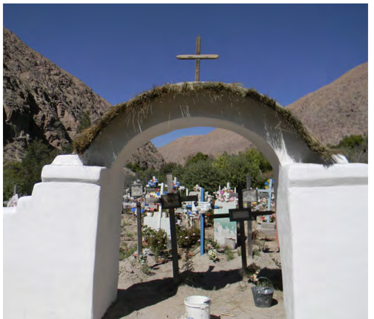
Restauración del cementerio de la iglesia de San Juan Bautista de Tímar.
